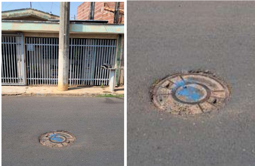
Imagem 1 e 2: à esquerda, identificação do logradouro e poço de visita, à direita e em destaque, evidencia da substituição da tampa do PV.
